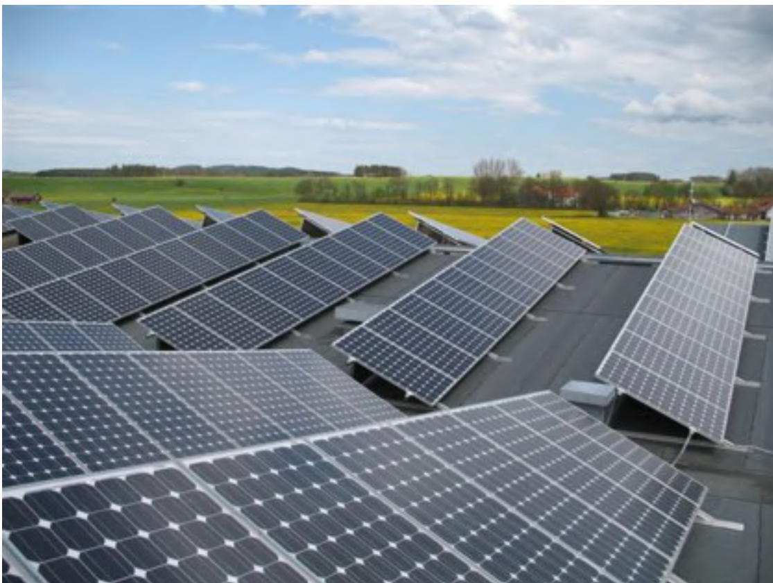
Panneaux photovoltaïques sur les toits de Rapunzel
